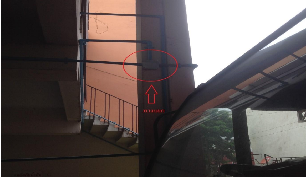
ทางแยกท่อลม
