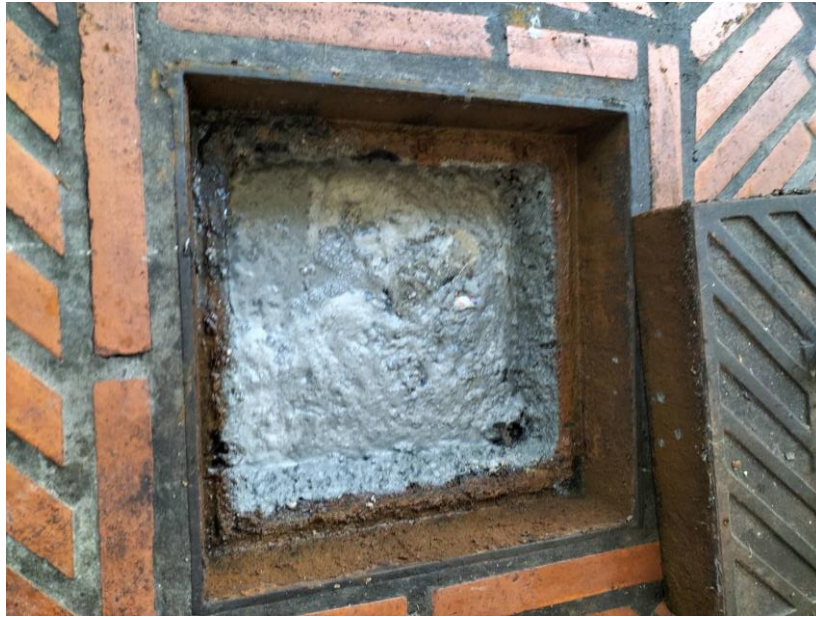
ภาพแสดงไขมันที่อุดตันในแนวท่อรับน้ำเสีย
