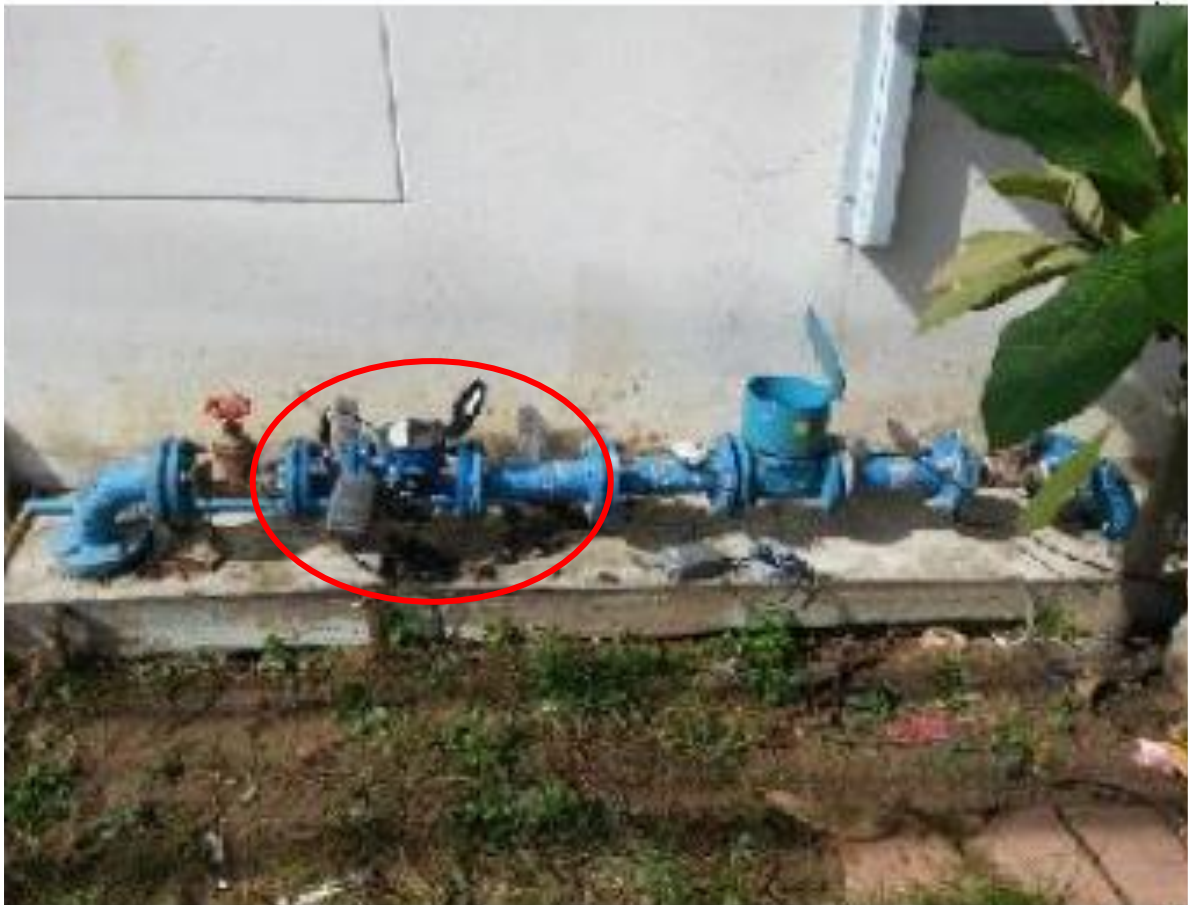
รูปที่ ๘ การติดตั้งมาตรอ้างอิง (Reference Meter) อนุกรมกับมาตร กปน.
