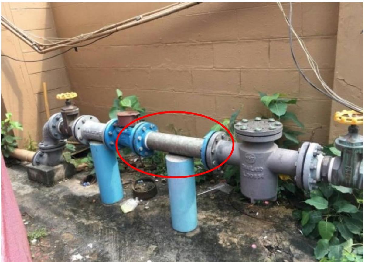
รูปที่ ๗ เปลี่ยนท่อสั้นหน้ามาตรเป็นท่อเหล็ก GI กรณีมาตรวัดน้ำขนาด \varnothing ๒ - ๖ นิ้ว
