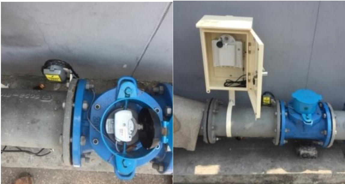
รูปที่ ๒ การติดตั้ง Pulse Unit ที่หน้าปัดมาตรวัดน้ำและตู้ Data logger
