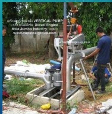
ลักษณะบ่อสูบน้ำขนาดเล็ก
