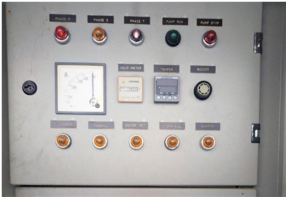
ภาพตัวอย่าง : ตู้ควบคุมเครื่องสูบน้ำไฟฟ้า
