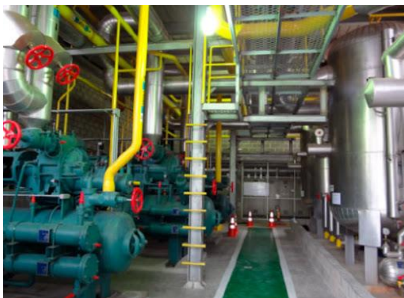
ภาพที่ ๕ แสดงการติดตั้งวาล์วนิรภัยและอุปกรณ์ระบายน้ความดันในจุดต่างๆของระบบทำความเย็น ในสถานที่ผลิตน้ำแข็ง
