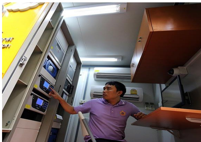
รูปภาพอุปกรณ์ภายในสถานีตรวจวัดคุณภาพอากาศและเสียง
