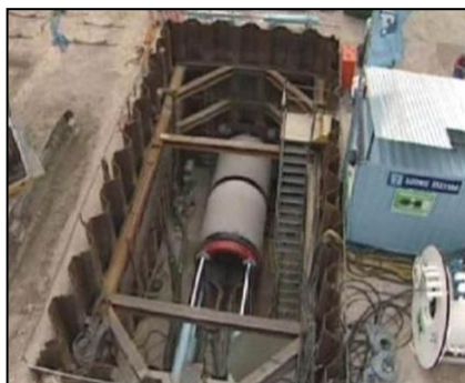
รูปที่ ๙ การวางท่อในพื้นที่ใหม่โดยวิธี Pipe Jacking
