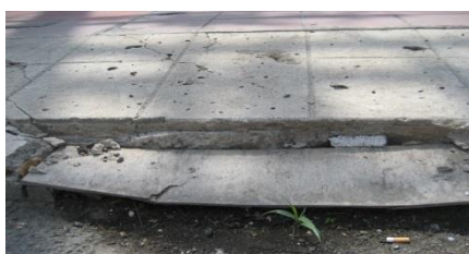
รูปภาพช่องทางระบายน้ำอุดตัน
