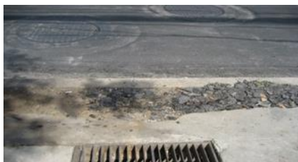
รูปภาพทางระบายน้ำชำรุด
