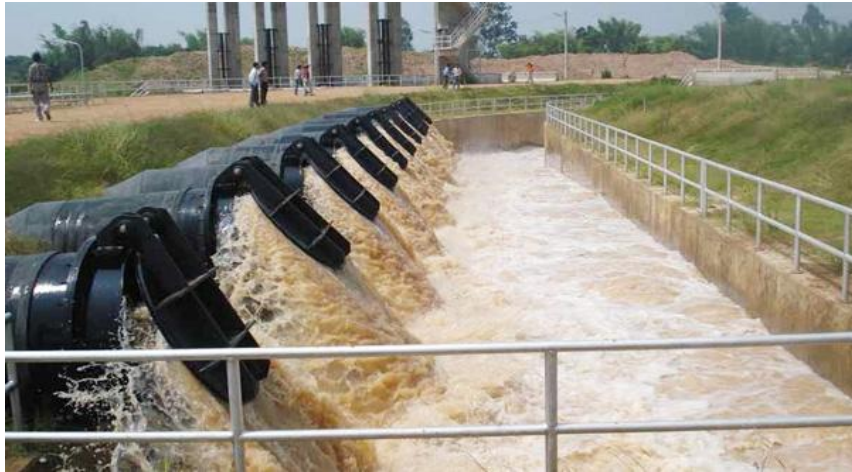
การระบายน้ำด้วยเครื่องสูบน้ำไฟฟ้า
