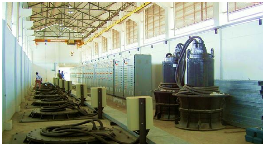
ห้องควบคุมเครื่องสูบน้ำไฟฟ้า
