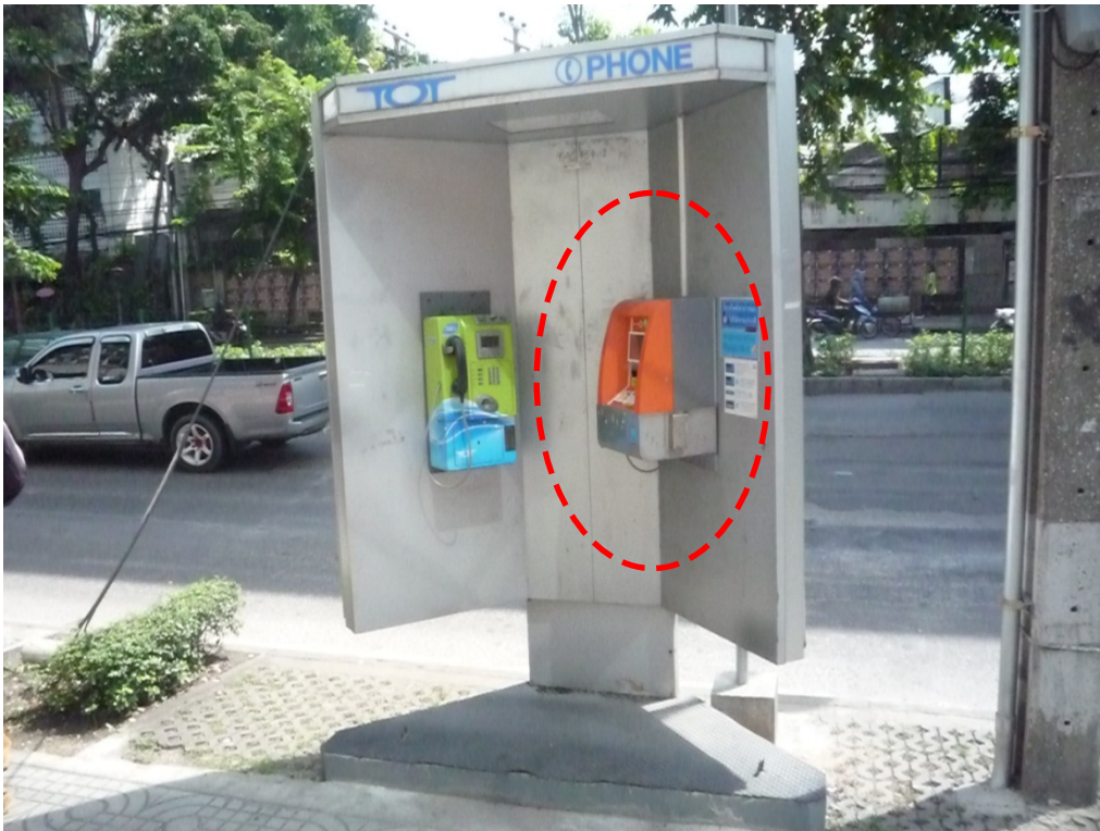
ภาพที่ 12 แสดงการติดตั้งเครื่องโทรศัพท์ที่สามารถเติมเงินออนไลน์แทนเครื่องโทรศัพท์สาธารณะเดิม บริเวณถนนพหลโยธิน
