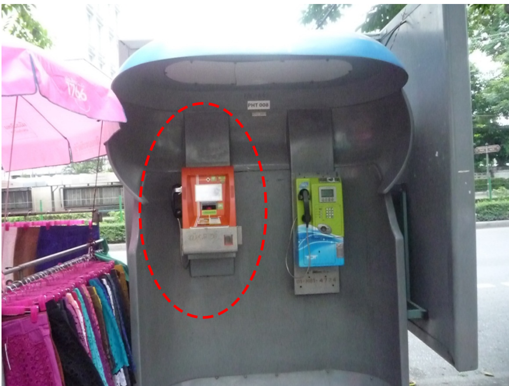
ภาพที่ 11 แสดงการติดตั้งเครื่องโทรศัพท์ที่สามารถเติมเงินออนไลน์แทนเครื่องโทรศัพท์สาธารณะเดิม บริเวณถนนพหลโยธิน
