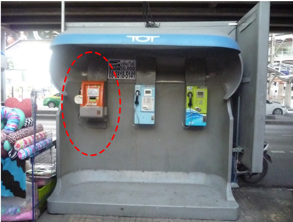
ภาพที่ 10 แสดงการติดตั้งเครื่องโทรศัพท์ที่สามารถเติมเงินออนไลน์แทนเครื่องโทรศัพท์สาธารณะเดิม บริเวณถนนพหลโยธิน
