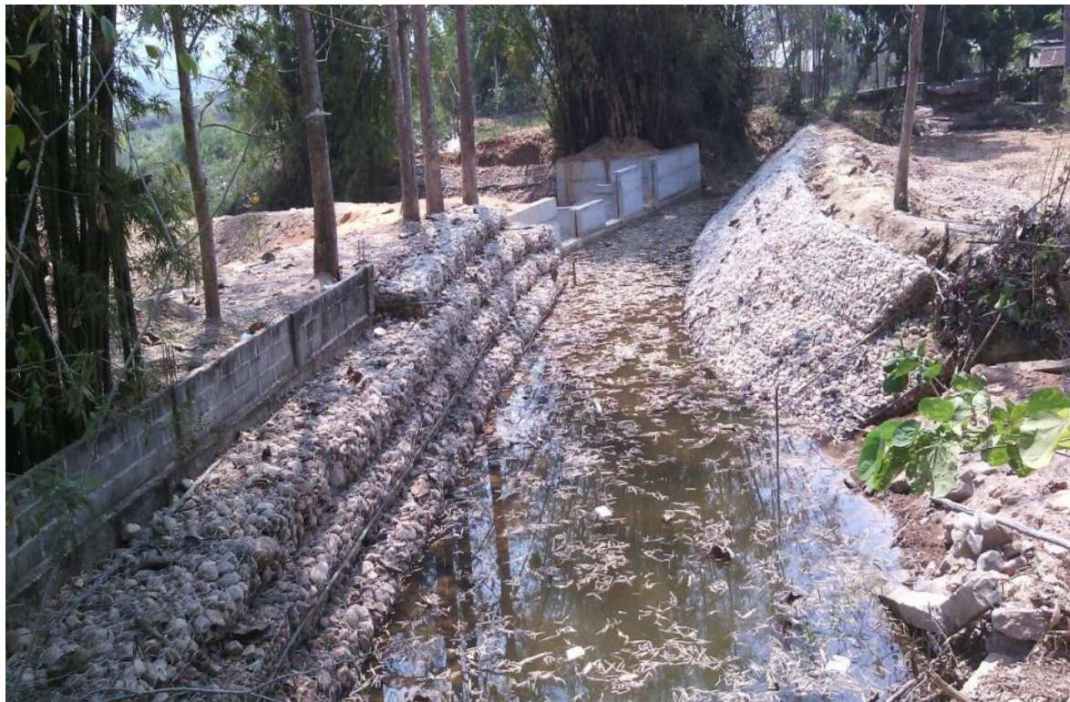
รูปที่ 4-4 ดำเนินการสร้างฝายช่วยน้ำยมจนแล้วเสร็จ
