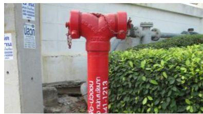
ภาพหัวจ่ายน้ำดับเพลิงแบบหัวแกละ
