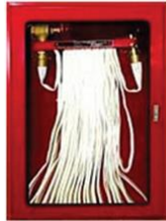
ชุดสายฉีดน้ำดับเพลิงแบบ Hose Rack
